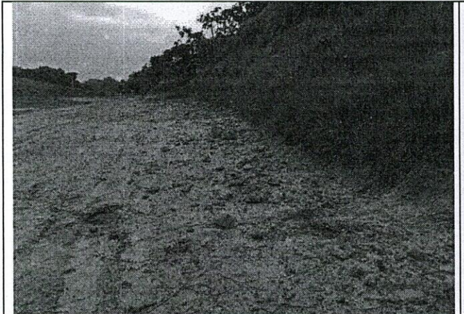
Fotografías 25: Estado actual, sin canaleta perimetral, sector nor-occidental. Fuente: Equipo Técnico CAS 2025
