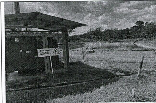
Fotografía 39: Área piscina sin cerramiento perimetral. Fuente: Equipo Técnico CAS 2025.
