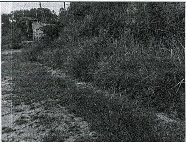
Fotografías 24: Estado actual, sin canaleta perimetral, sector nor-occidental. Fuente: Equipo Técnico CAS 2025
